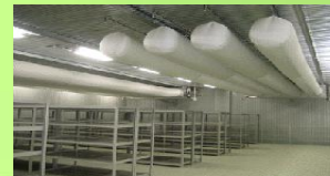
ソックダクト
