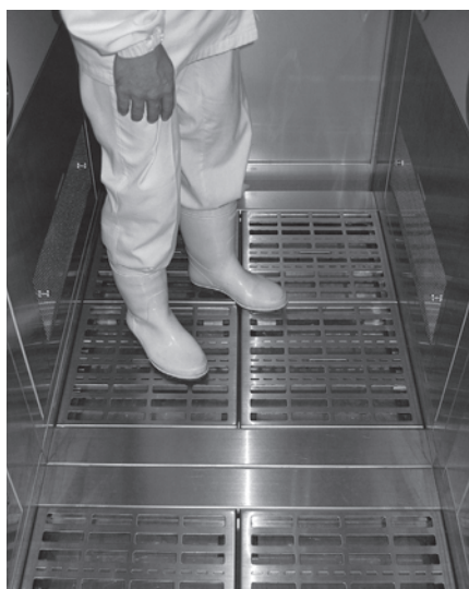
● エアーシャワー室のスリット床 (ウェット)
