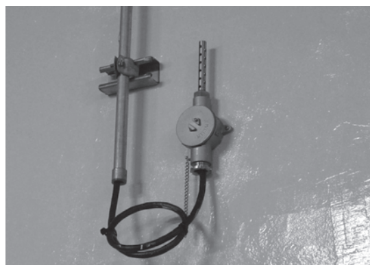
適切な冷凍保管庫の温度センサー設置
