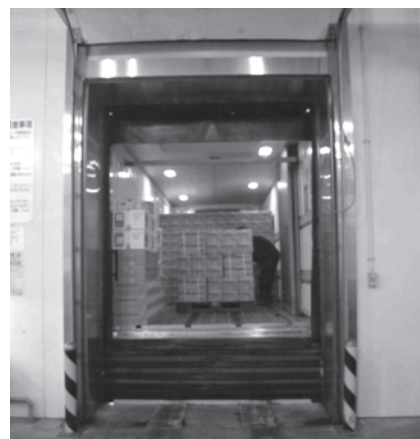
搬出入口のドックシェルター
